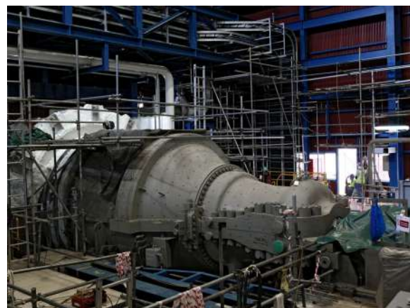
Ci-dessus et ci-dessous : La centrale d'Azito Énergie fournit entre 25 et 30 % de l'électricité produite en Côte d'Ivoire.
