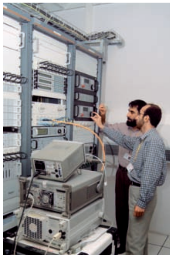
À KABOUL, LE CENTRE DE GESTION RÉSEAU FAIT PARTIE DU RÉSEAU DE TÉLÉPHONIE MOBILE GSM DE POINTE MIS EN PLACE EN AFGHANISTAN.
